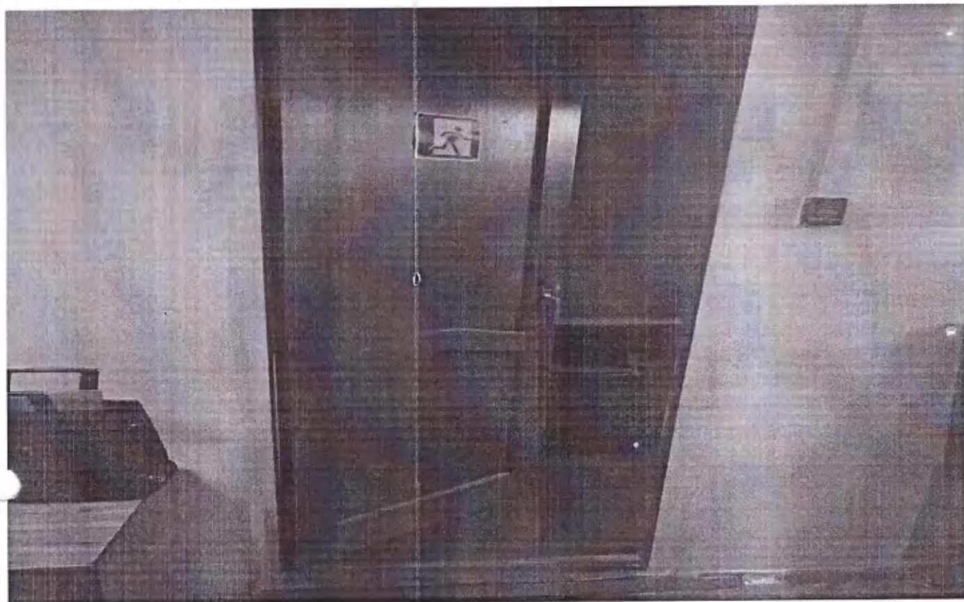
Фото № 11, на фото изображен запасной выход и пути эвакуации
