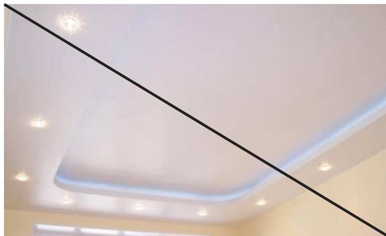
Плохо Многоуровневые гипсокартонные конструкции
