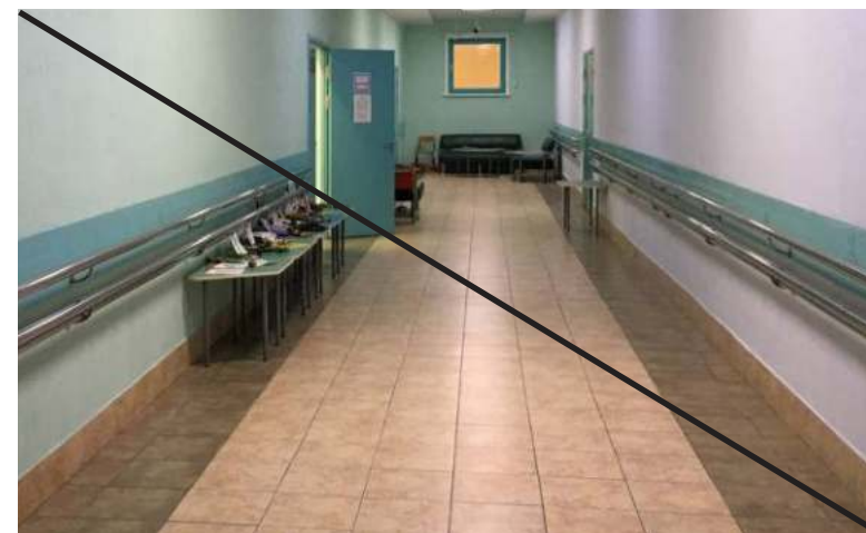
Плохо Керамогранитная плитка с крупными швами
