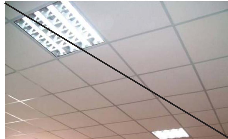
Плохо Открытые направляющие
