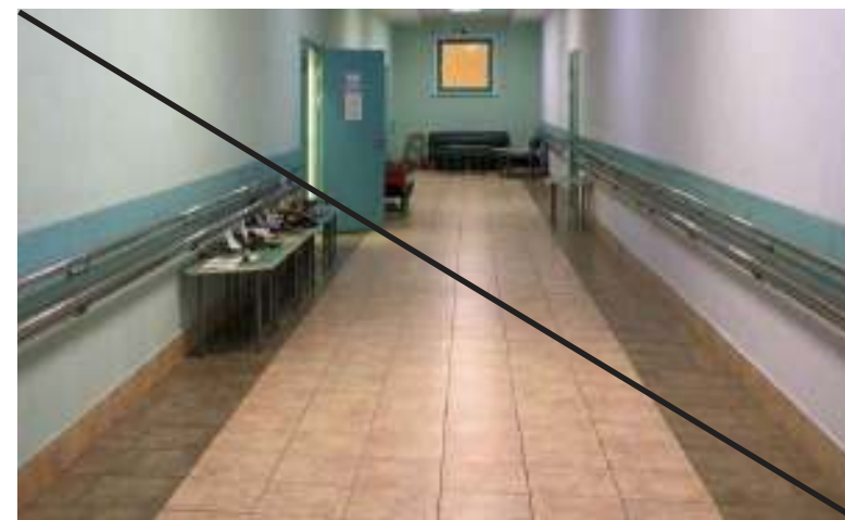
Плохо Керамогранитная плитка с крупными швами
