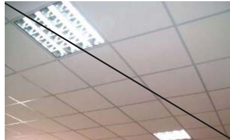
Плохо Открытые направляющие
