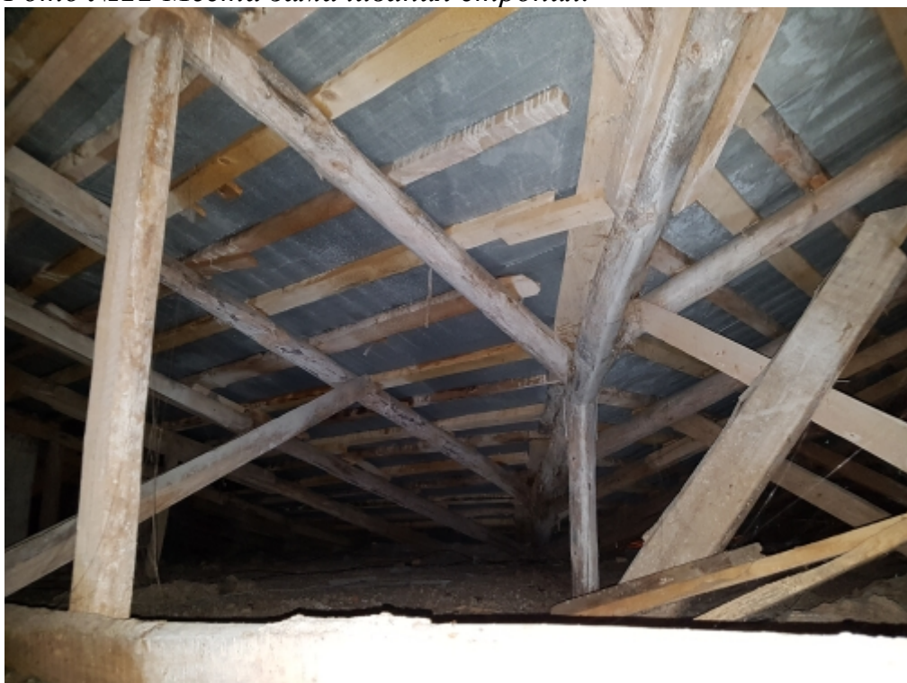
Фото №22 Места замачивания стропил.
