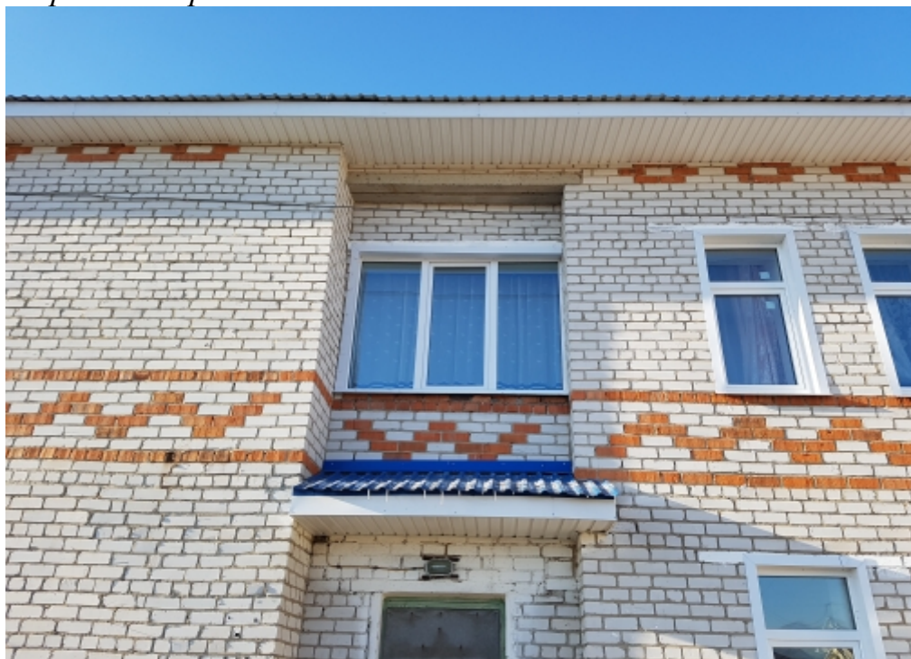
Фото №24 Отсутствие организованного водостока и снегозадержания кровли.
