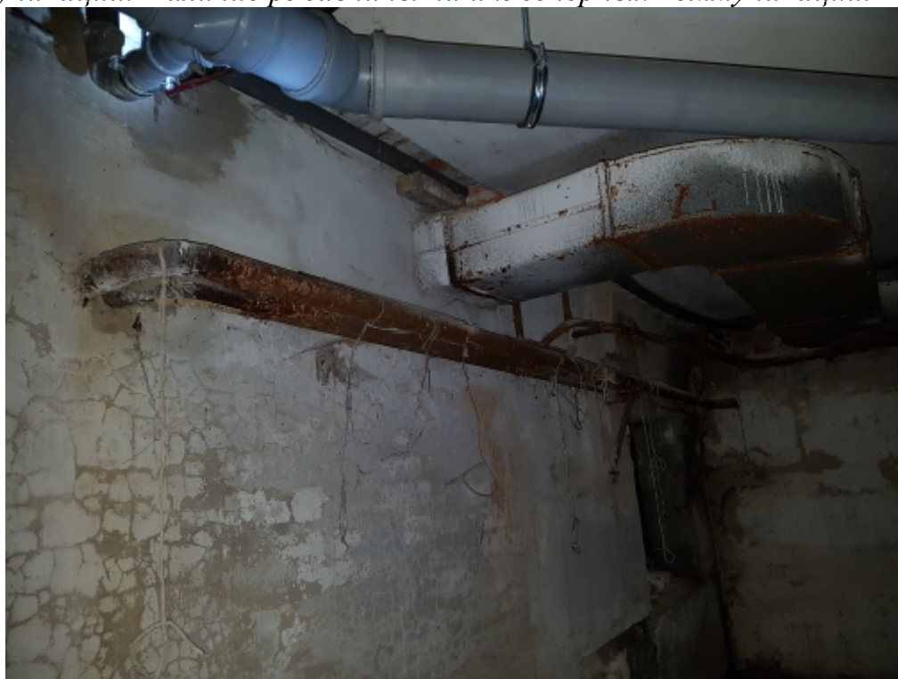
Фото №34 Неудовлетворительное состояние инженерных коммуникаций. Наличие ржавчины на инженерных коммуникациях.
