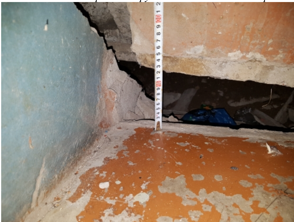
Фото №20. Место просадки грунта под лестничным маршем.
