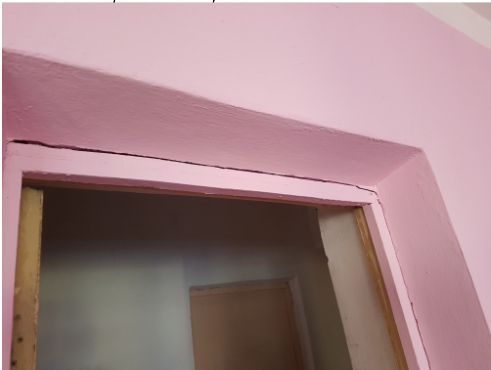
Фото №29 Коробление дверного блока.
