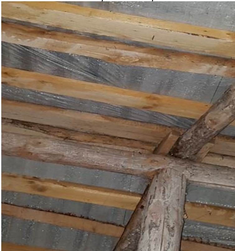
Фото №23 Место протечки кровли и замачивания стропил .
