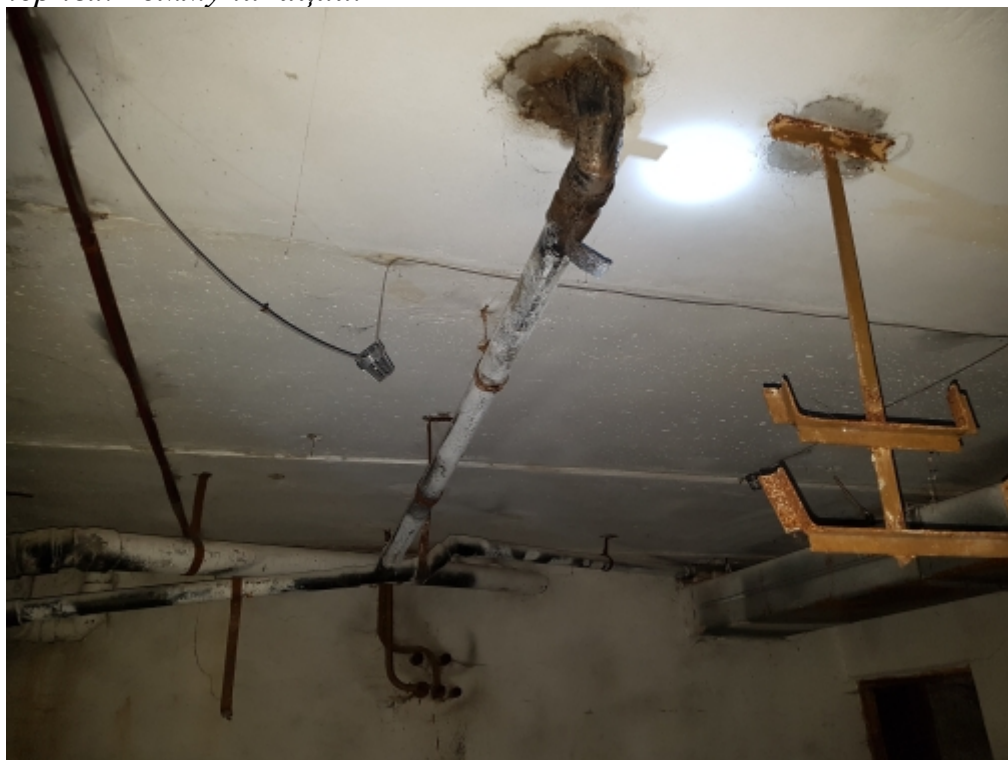
Фото №33 Протечки в местах прохода инженерных коммуникаций. Неудовлетворительное состояние инженерных коммуникаций.
